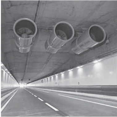
Aplicación de ventilación
