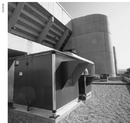
Aplicación de tratamiento del aire
