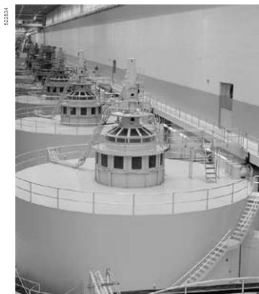
Aplicación de bombeo
